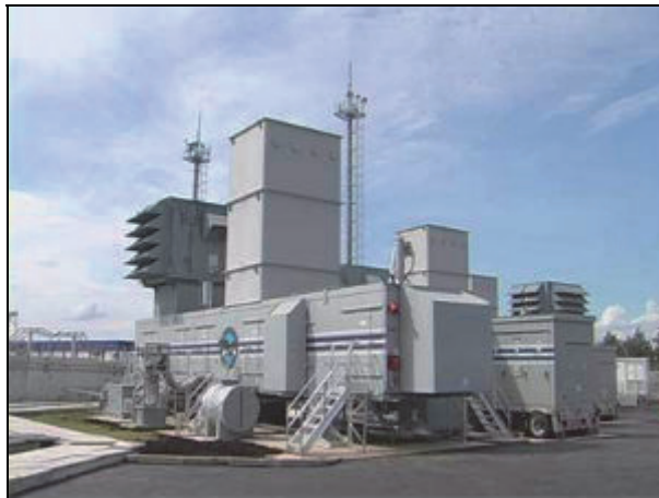
Рис. 2.11. Мобильная газотурбинная электростанция
