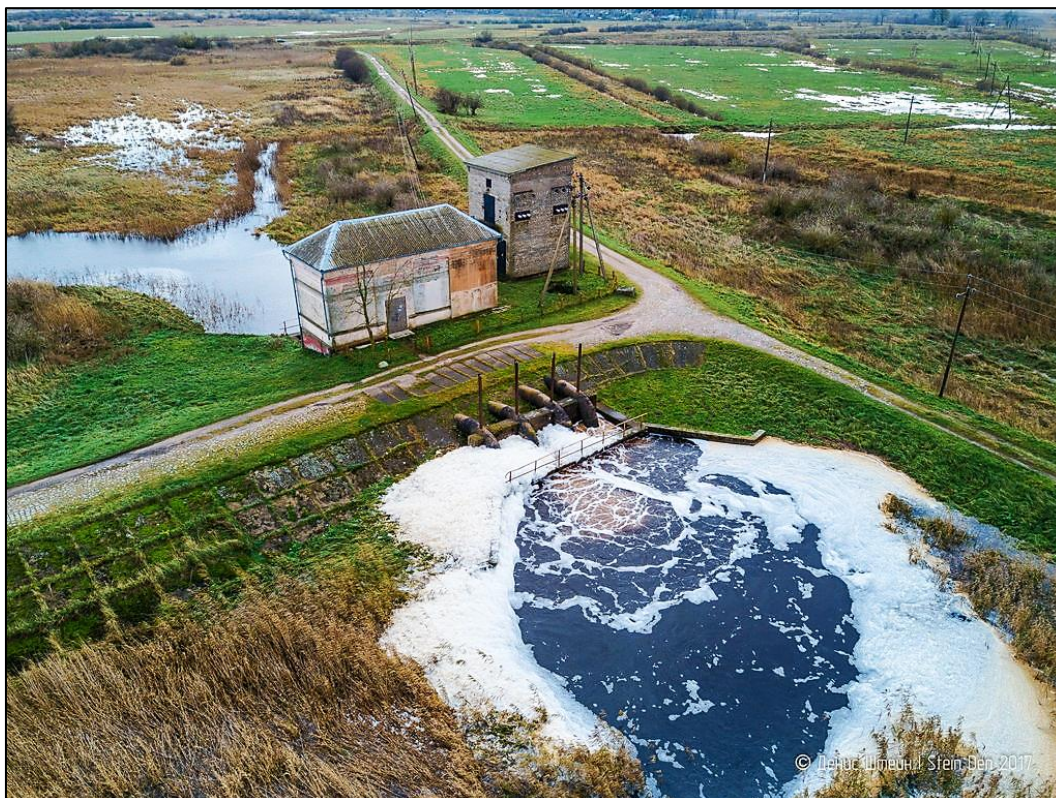
Рис. 13.15. Насосная станция вблизи пос. Петино, Полесский муниципальный округ
