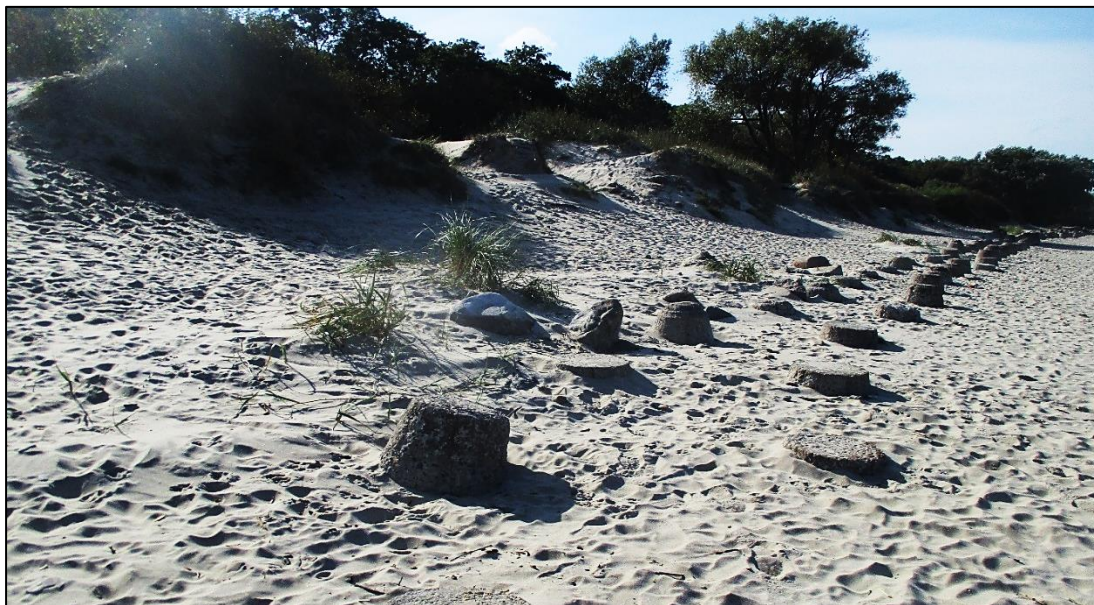
Рис. 3.12. Аварийный участок берега на прикорневом участке Куршской косы, на мониторинговом пункте № 198
